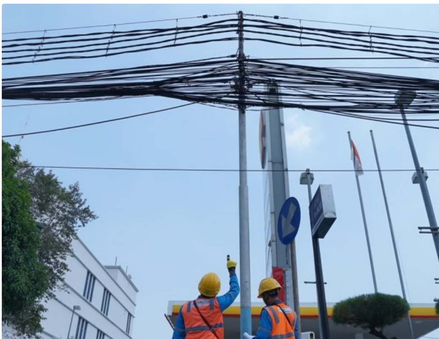
Photo: Titik Lokasi pencuri Kabel PLN
